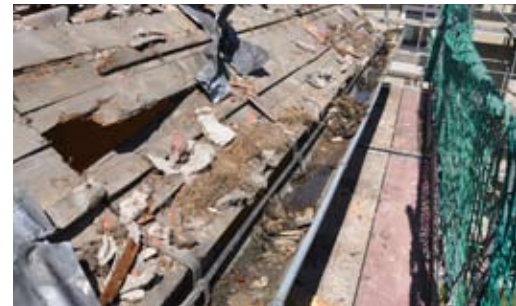
Abgedecktes Dach mit Nistmaterial
