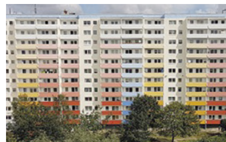
Hochhausiedlung (Plattenbau): Ca. 30.000 m 2 Fassadenfläche konnten ohne vorheriges Ausgleichen des Untergrundes mit dem Aerogel-Dämmputz gedämmt werden.
