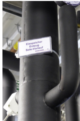
Eisspeicher sind große Wasserbehälter. Sie nutzen die Energie aus dem Phasenübergang von Wasser zu Eis. Fotos: Sebastian Krug
