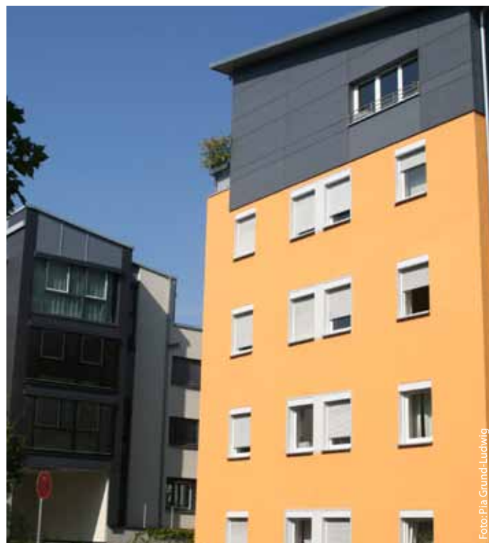
Die Gestaltung der Fassade beeinflusst die Veralgung.
