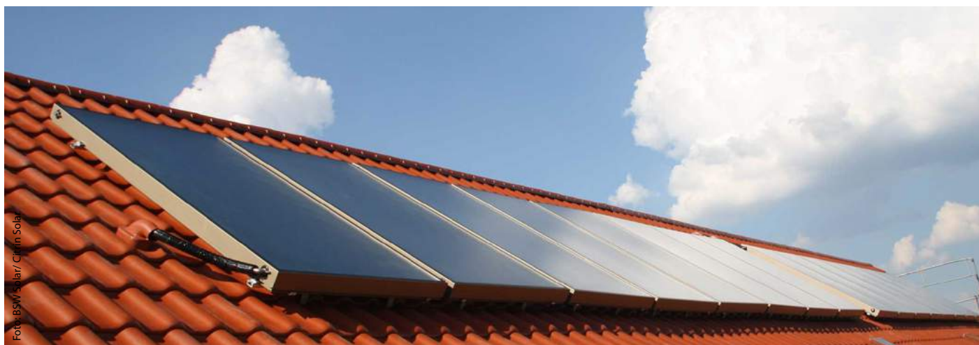
Eine Solarthermieanlage verhilft Öl- und Erdgasheizungen zu einer höheren Effizienzeinstufung.
