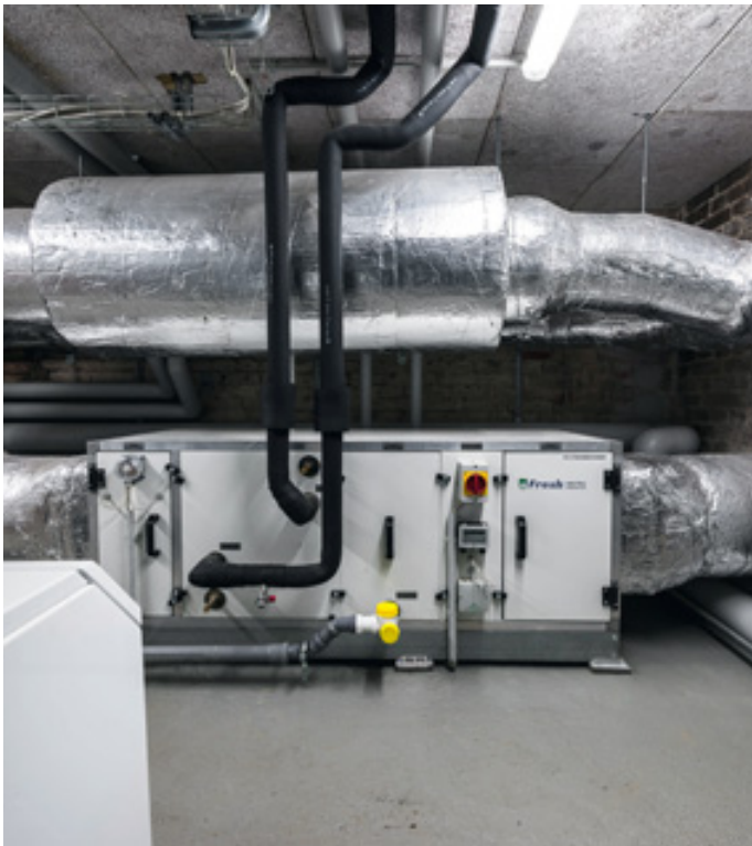
Nach der Sanierung einer Siedlung der Wohnungsbaugenossenschaft Märkische Scholle in Berlin haben alle Wohnungen Lüftungsanlagen. Die Wärme wird über eine Wärmepumpe zurückgewonnen.
